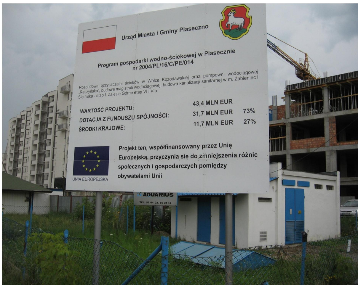
Magistrala wodociągowa w ul. Mleczarskiej oraz pompownia wodociągowa „Raszyńska”. SIWZ Nr 2004/PL/16/C/PE/014-2/06. – PIASECZNO
